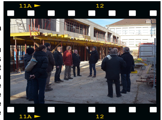
Le 23 décembre, visite du chantier de l'école Briand, par les élus, en présence de la directrice et de l'architecte.
